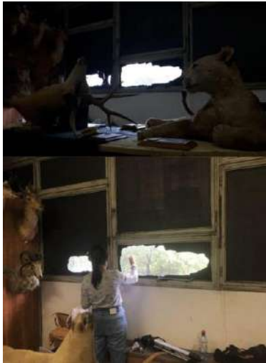
Figura 5. Condiciones inadecuadas de los cerramientos vidriados del depósito de almacenamiento.
