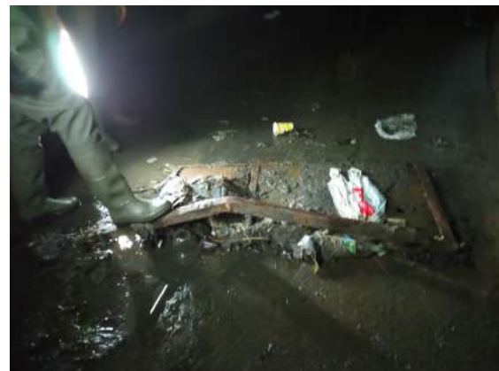
Figura 5 Detalle de obstrucciones en la red del sistema de saneamiento (Montevideo, Punta Carretas).
