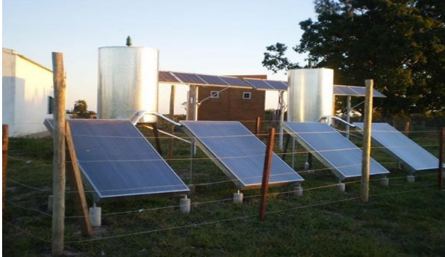
Figura n.º 2. Fotografía de una instalación típica de los calefones instalados
