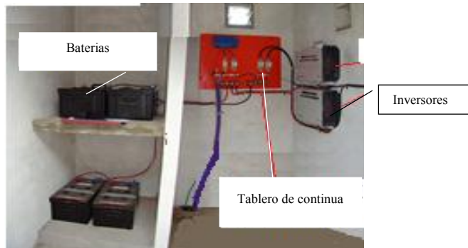
Figura n.º 9. Vista de la casilla de baterías
