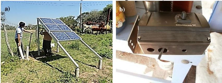
Figura n.º 13. Formosa - a) Montaje del banco de generación. b) Controlador con MPPT
