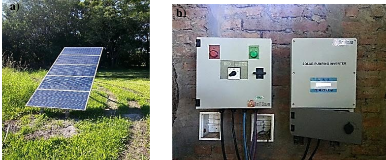
Figura n.º 12. Corrientes - a) Montaje del banco de generación. b) Sala de máquinas mostrando tablero de conmutación e inversor
