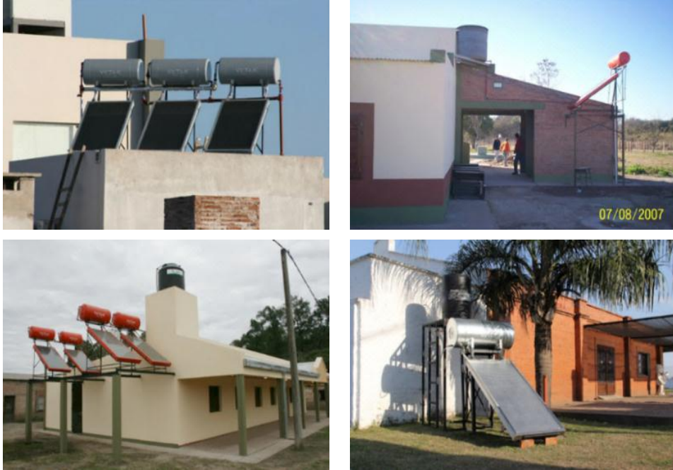
Figura n.º 3. Diferentes instalaciones de calefones solares de la empresa VETAK
